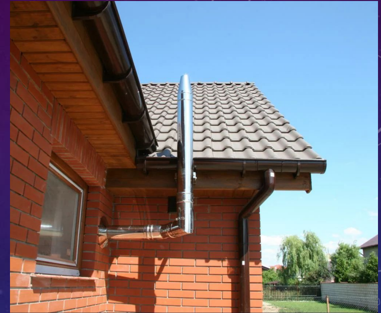
Выбросное устройство системы вентиляции
