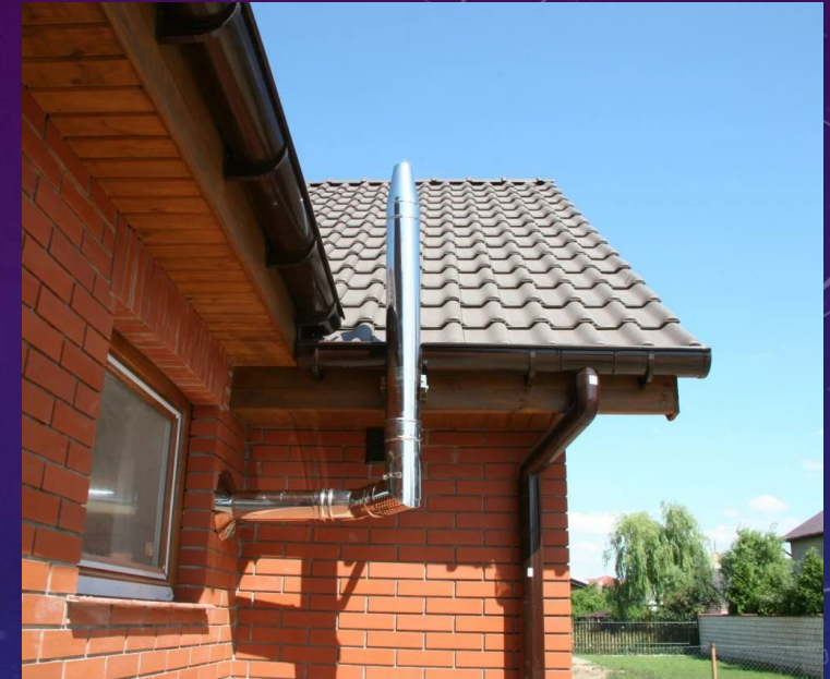
Выбросное устройство системы вентиляции
