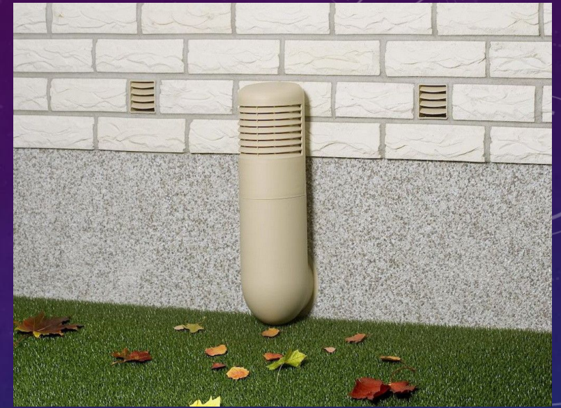
Приемное устройство системы вентиляции
