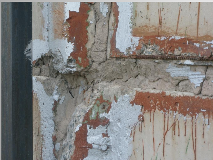
Разрушение цементного наполнителя в швах между согами
