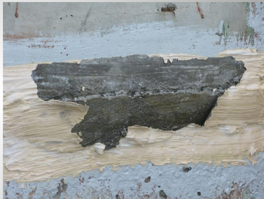
Отслоение герметика от шва между согами, покрытого лаком на битумной основе
