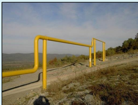
Наземные и надземные распределительные газопроводы
