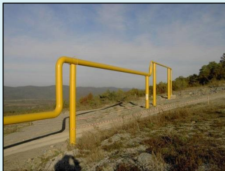
Наземные и надземные распределительные газопроводы
