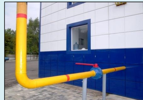
Газопроводы - вводы с установленной на них запорной арматурой
