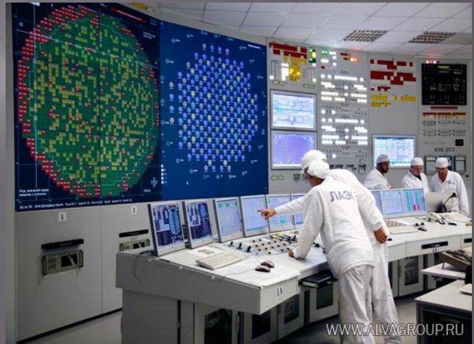
Ленинградская АЭС Блочный щит управления
