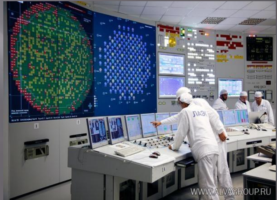
Ленинградская АЭС Блочный щит управления
