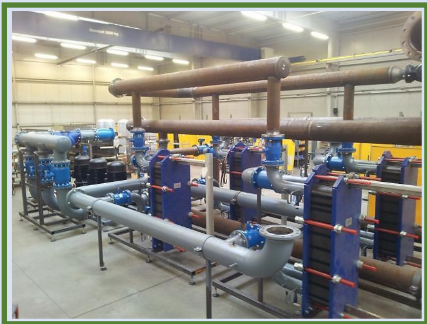
ЦЕНТРАЛЬНЫЕ ТЕПЛОВЫЕ ПУНКТЫ
