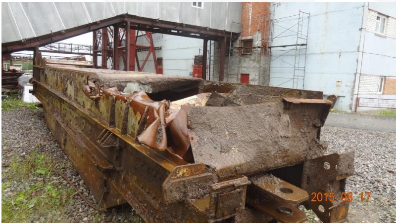
Инцидент, повреждение скупа
