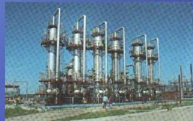
Установка для очистки и осушки газа
