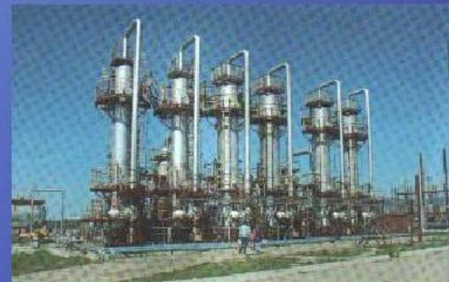
Установка для очистки и осушки газа
