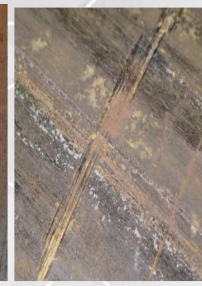
Рисунок 6 - Продеры Нарушение целостности поверхностного слоя листа или трубы с образованием углублений произвольной длины, геометрии и глубины. Поверхность в области дефекта может быть светлой или покрытой ржавчиной. Образуется от резкого трения проката о детали подъемно - транспортного оборудования. Поперечные и продольные продеры. (1020 1420)
