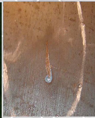
Рисунок 5 - Задиры Дефект поверхности в виде канавки с собранным на конце металлом. Образуется от царапания поверхности металла о детали подъемно - транспортного оборудования. Хаотично расположенные на наружной и на внутренней поверхности трубы. (1020 и 1420)
