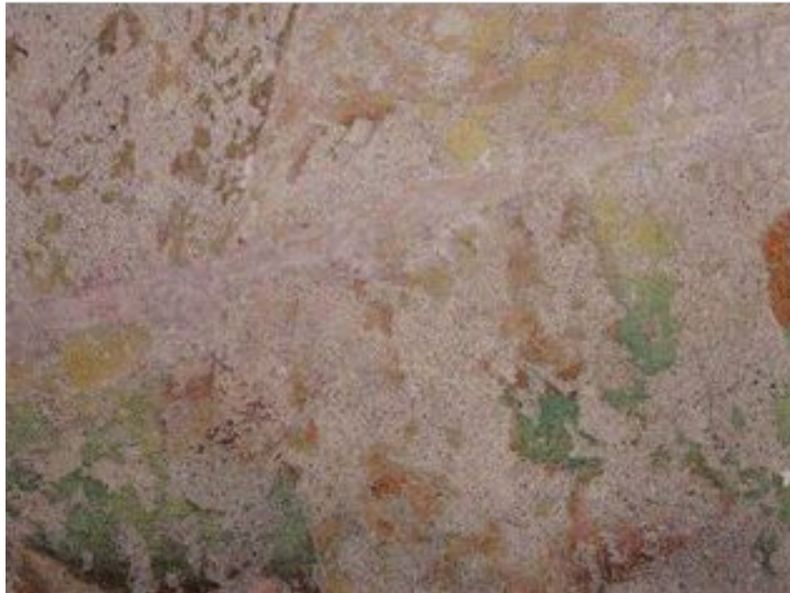
Изображение разрушенного красочного слоя
