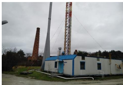
24 котельная , г Геленджик ,ул. Короленко, 2
