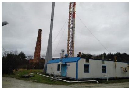
24 котельная , г Геленджик ,ул. Короленко, 2
