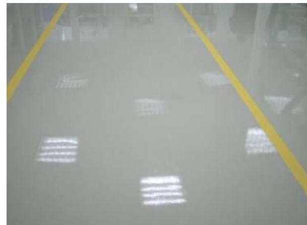
Чистота производственных полов
