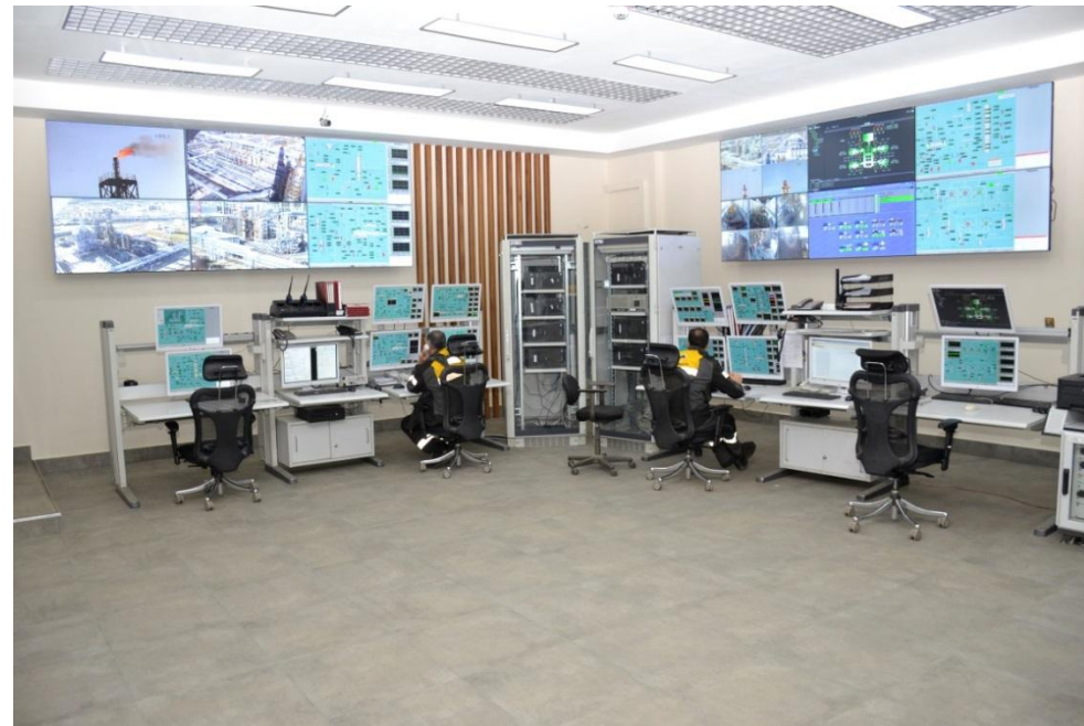
Рабочее место оператора технологических установок
