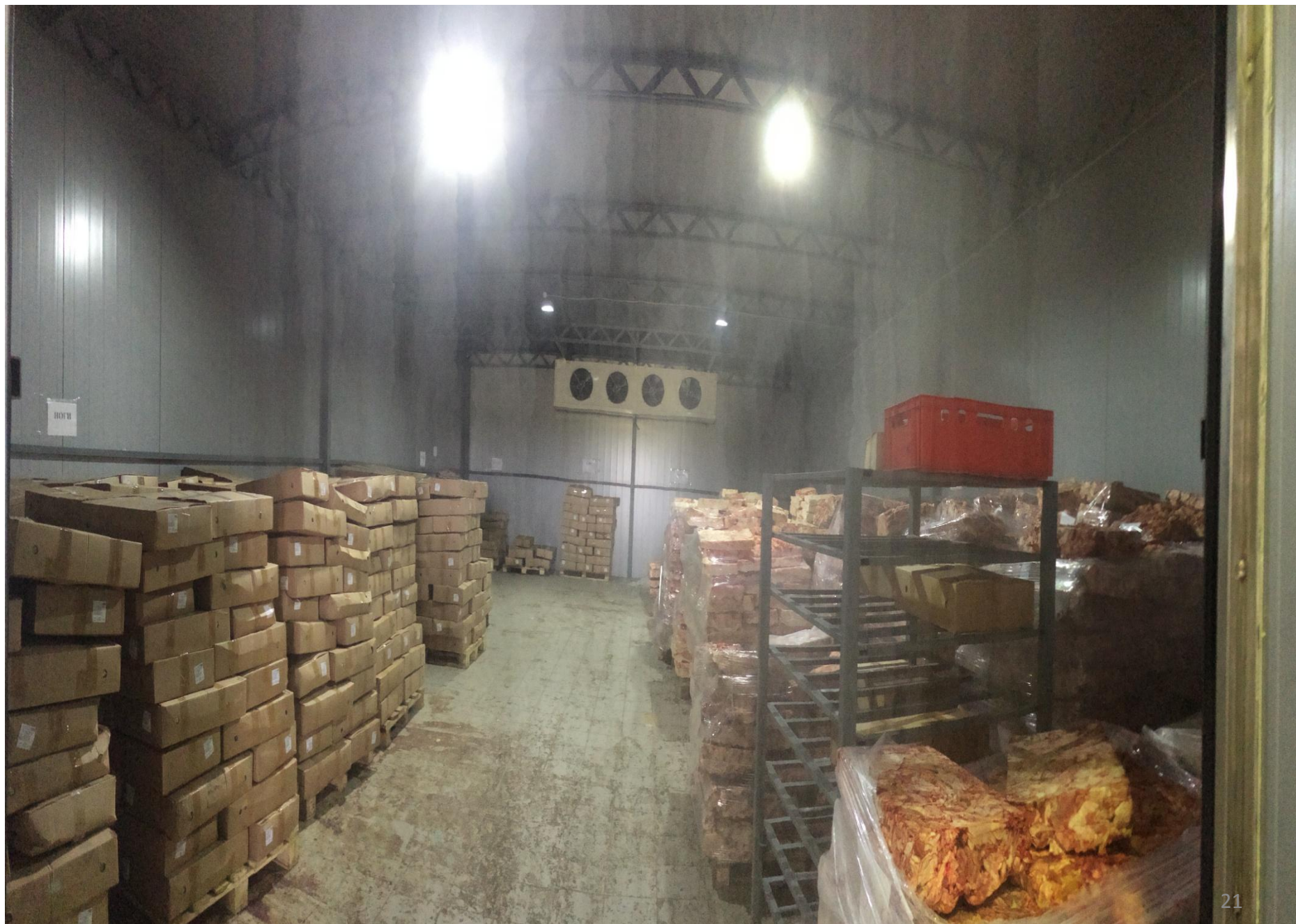
Мясоперерабатывающее предприятие. Холодильник готовой продукции.
