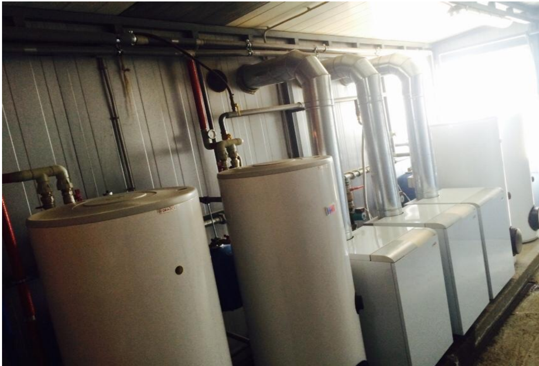
Мясоперерабатывающее предприятие. Котельная.
