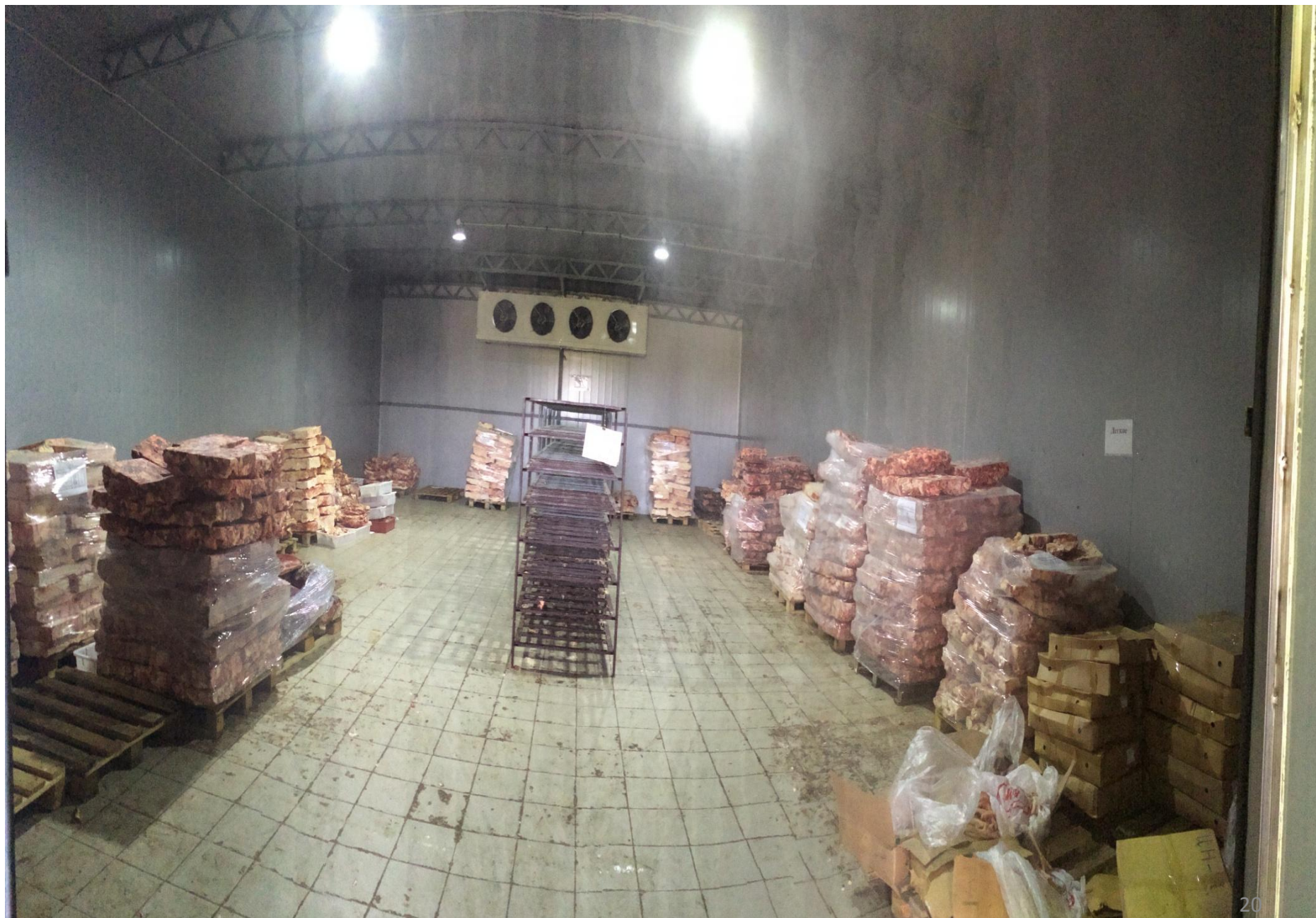
Мясоперерабатывающее предприятие. Холодильник готовой продукции.
