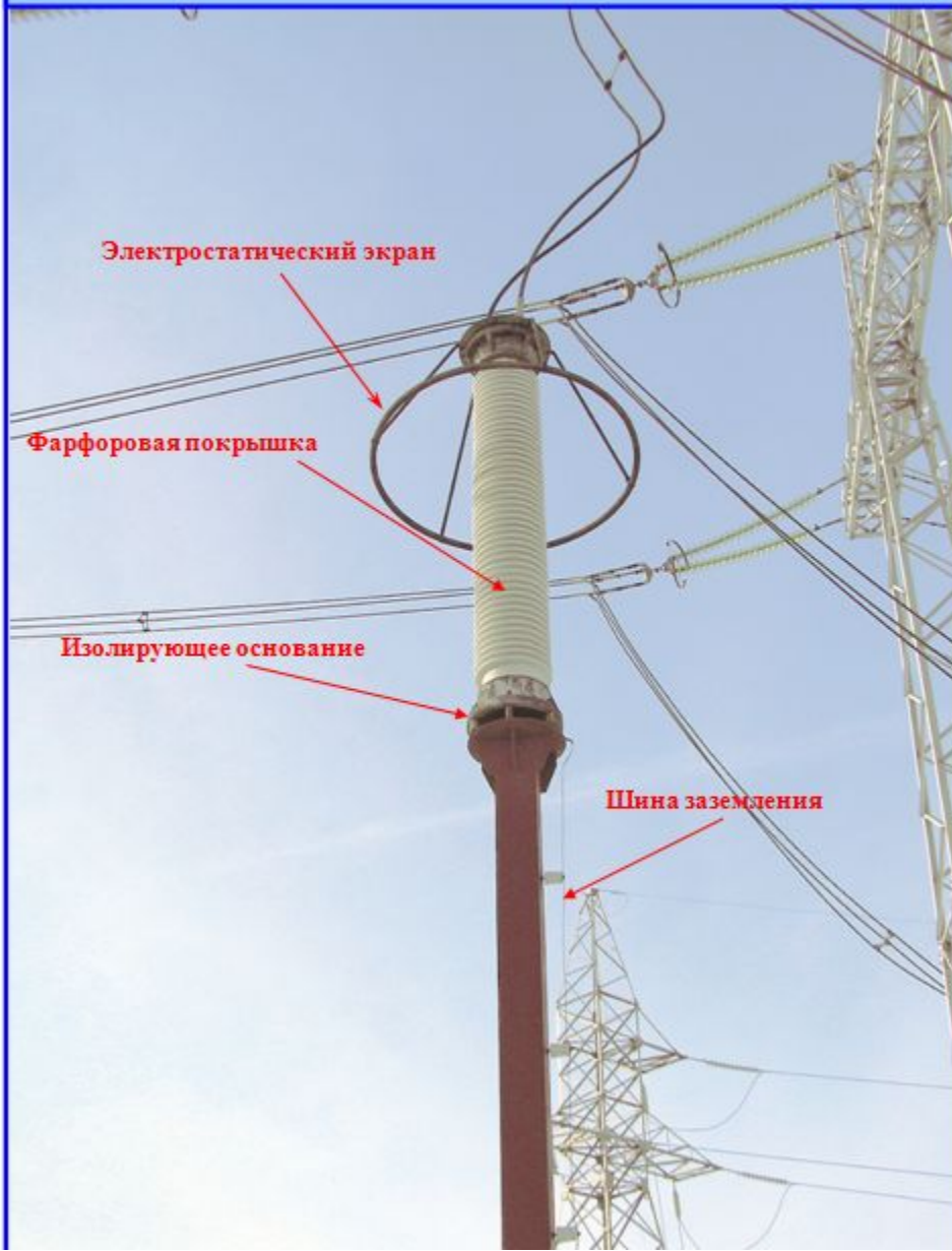
Ограничитель грозовых и коммутационных перенапряжений нелинейный ОПН – 330У1
