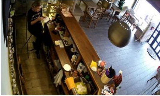
Установка видеонаблюдения в кафе
