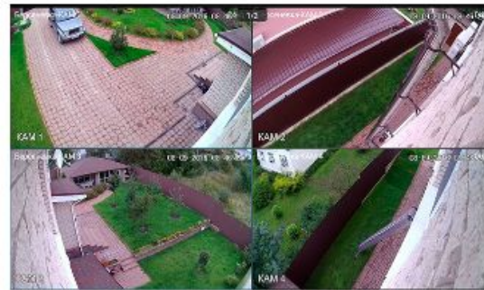
Установка видеонаблюдения по периметру
