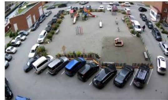
Установка видеонаблюдения на парковке
