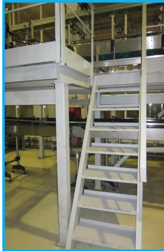
Оснащение площадки транспортера упаковок ПЭТ-линии лестницей
