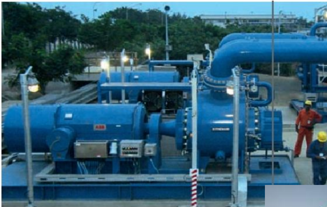
ЭВН установка электро-винтового насоса (УЭВН)
