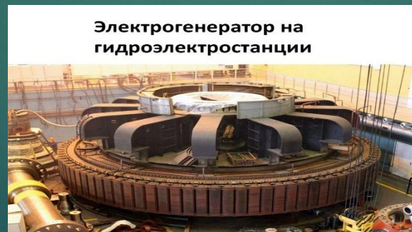
Рис. 18 - Электрогенератор на ГЭС
