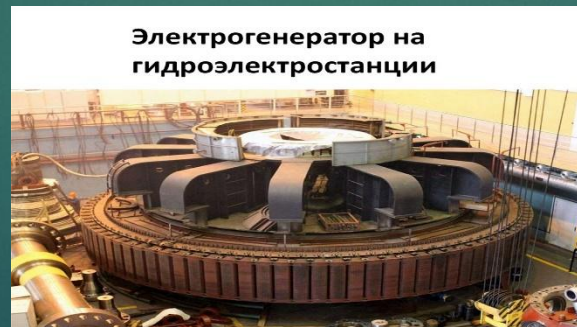
Рис. 18 - Электрогенератор на ГЭС
