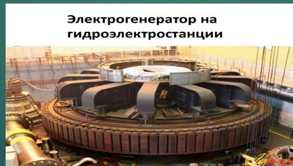
Рис. 18 - Электрогенератор на ГЭС
