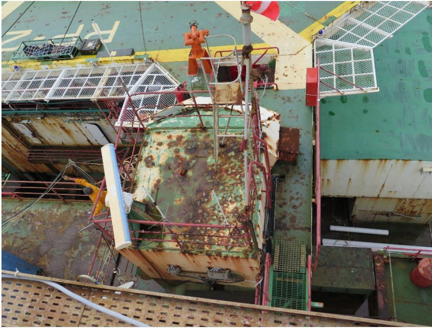
Пример установки РЛС на крыше СВКП РП-2
