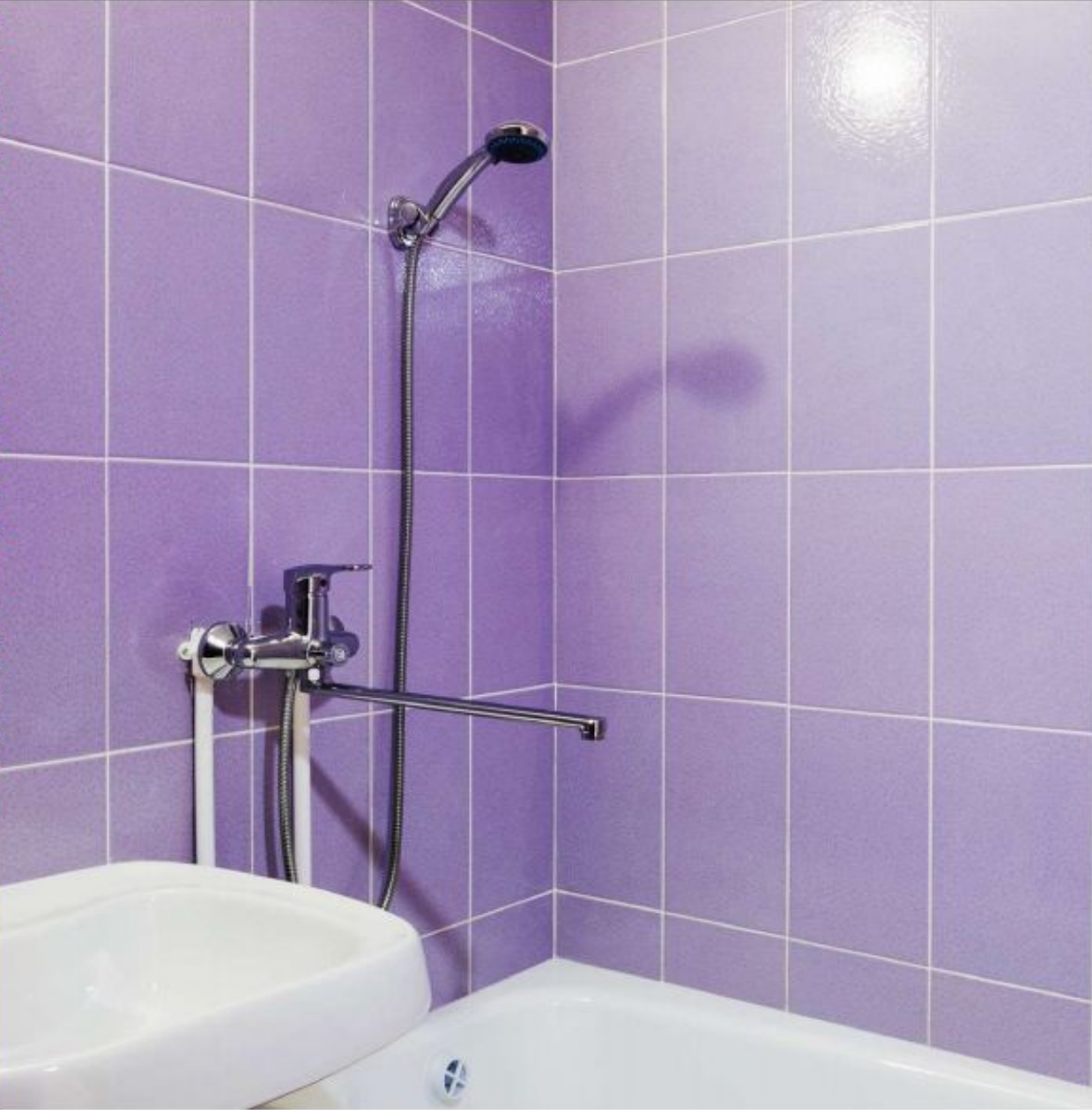
Качественное оснащение санузла является обязательным условием сдачи новой квартиры. Раковина с пьедесталом и смесителем устанавливается в ванной комнате.
