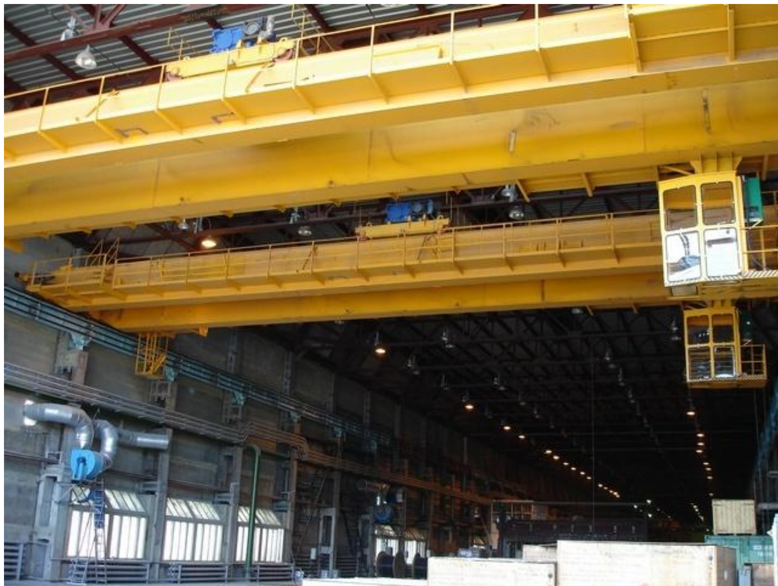
Мостовые краны с машинным приводом
