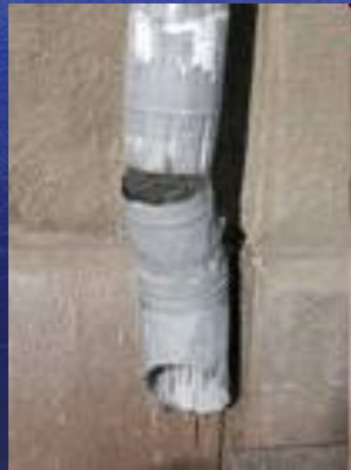
Водосточная труба, разорванная льдом
