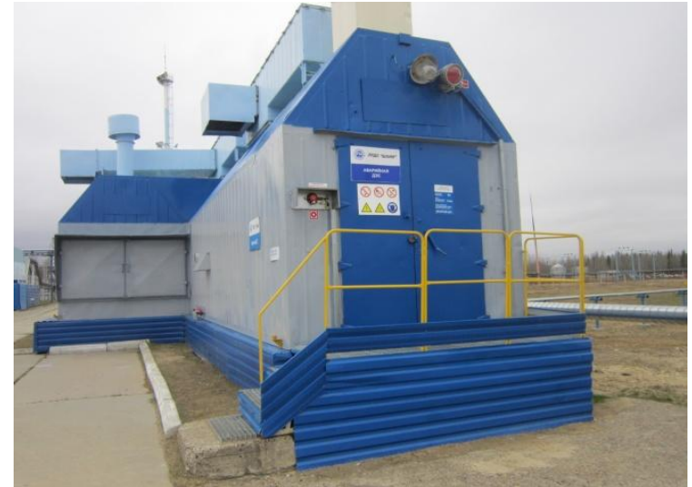
Внешний вид ДЭС мощность 630 кВА
