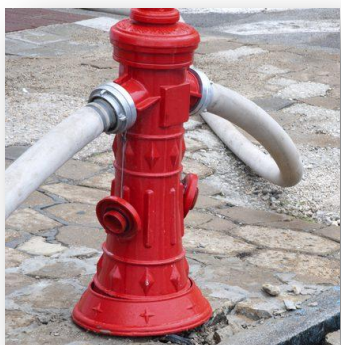
Hydrant na ulici
