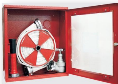
Hydrant v budove
