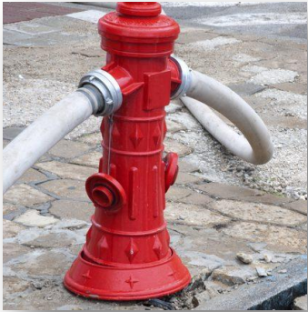
Hydrant na ulici
