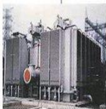
Сверхвысоковакуумный трансформатор 1050 кВ / 3000/3 МВА
