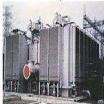
Сверхвысоковакуумный трансформатор 1050 кВ / 3000/3 МВА
