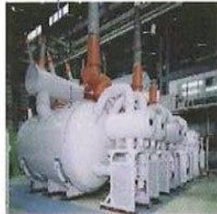
Трансформатор с элегазовой изоляцией (самый большой в мире) 330 кВ / 400 МВА
