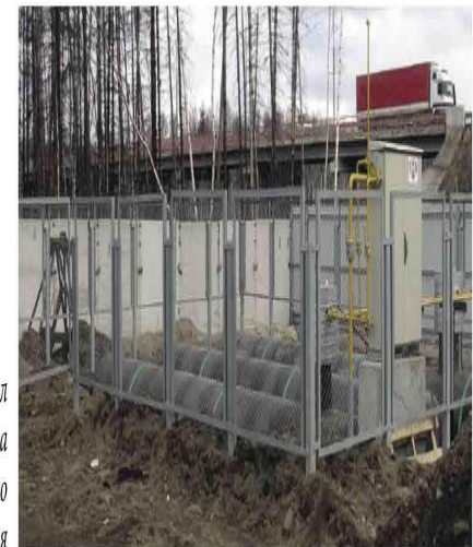
Резервуарный узел комплекса автономного газоснабжения
