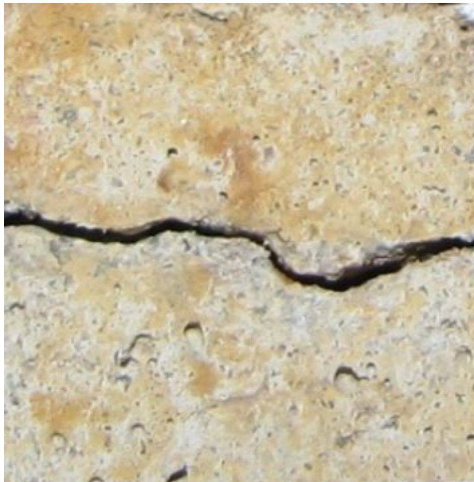
Коррозионная трещина Увеличение x12
