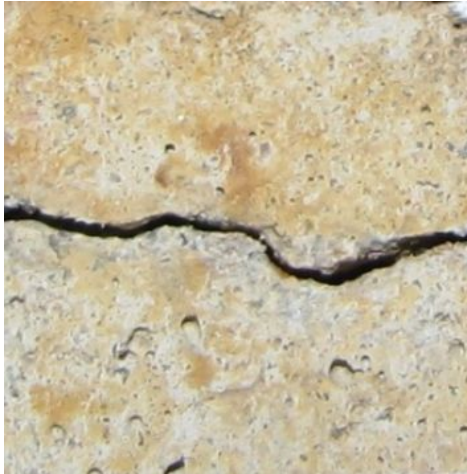
Коррозионная трещина Увеличение x12
