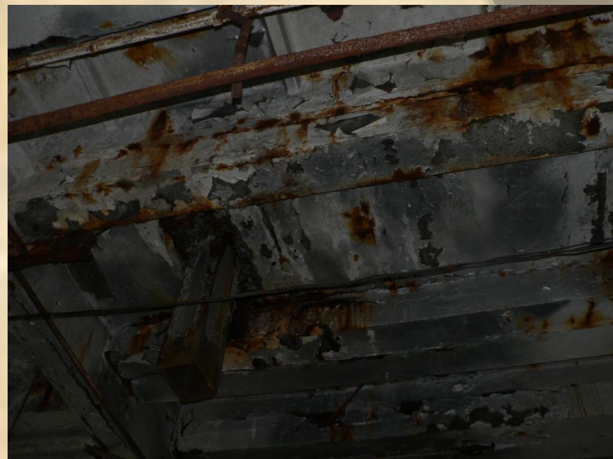
Состояние перекрытия 1-го этажа
