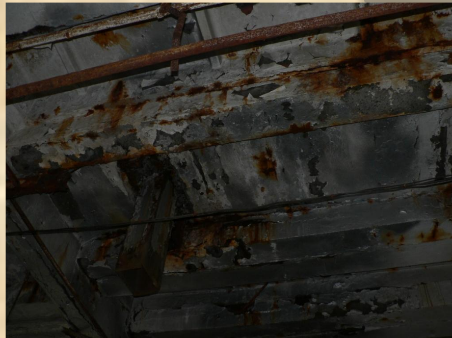
Состояние перекрытия 1-го этажа
