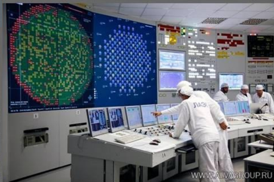
Ленинградская АЭС. Блочный щит управления
