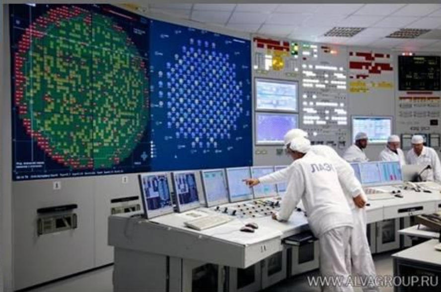
Ленинградская АЭС. Блочный щит управления
