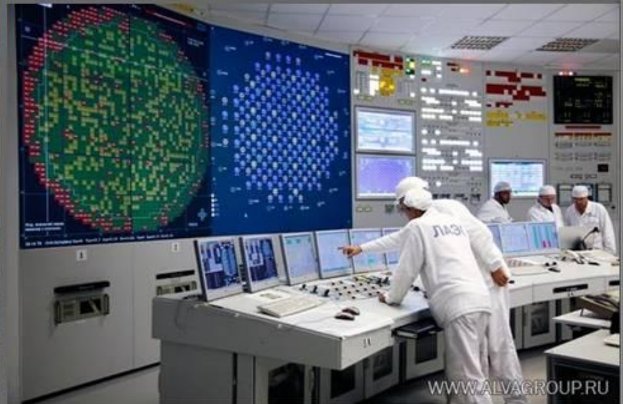
Ленинградская АЭС. Блочный щит управления
