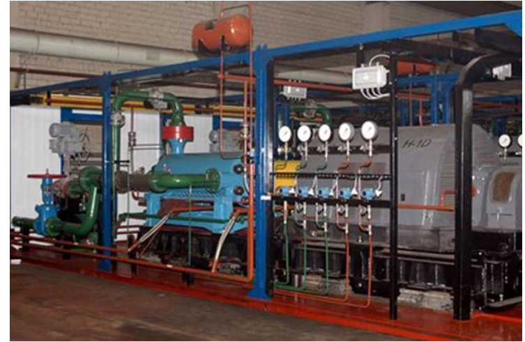
Блочная кустовая насосная станция
