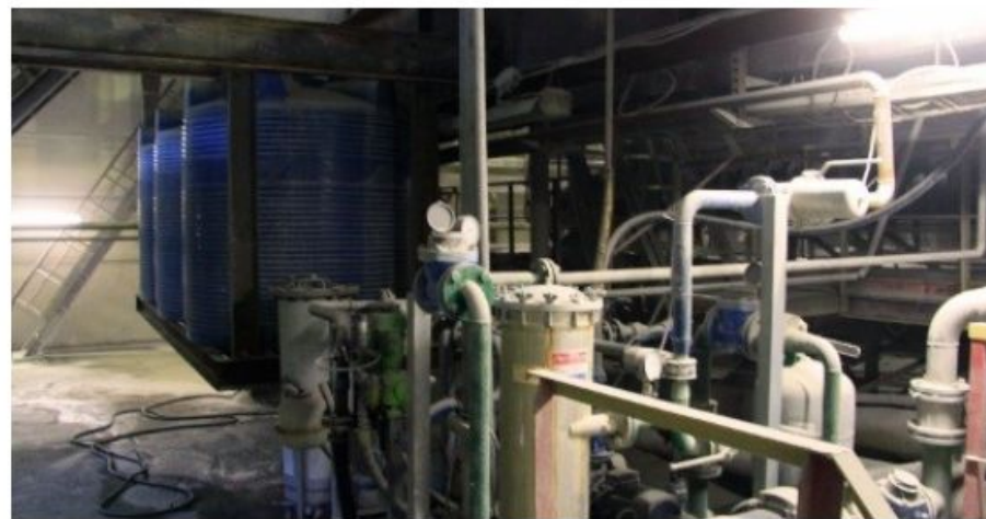
Реагентная подготовка очистки керамического фильтра
