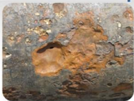
Язвенная коррозия и питтинг
