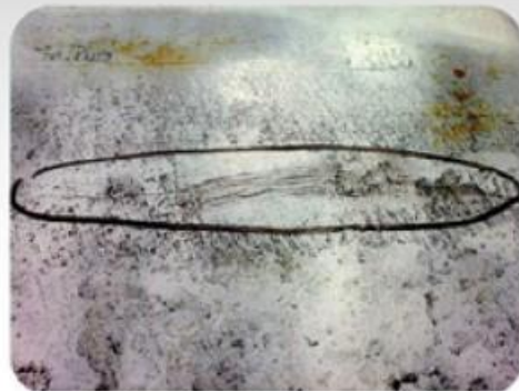
Коррозионное растрескивание под напряжением (КРН)
