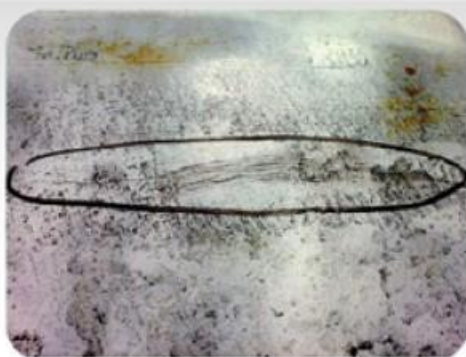
Коррозионное растрескивание под напряжением (КРН)
