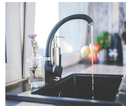
Кран распределительной сети
