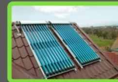
Водяные солнечные коллекторы
