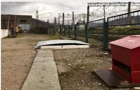
Резервуар дизельное топливо №4, 50м 3
