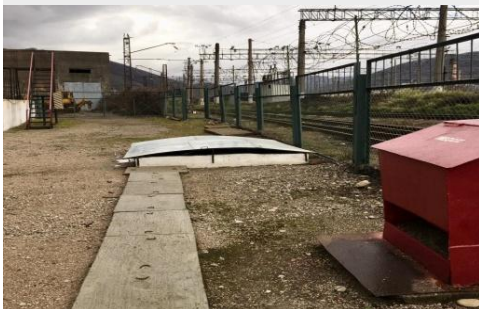
Резервуар дизельное топливо №4, 50м 3
