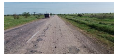
Покрытие автодорог требует реконструкции и ремонта
