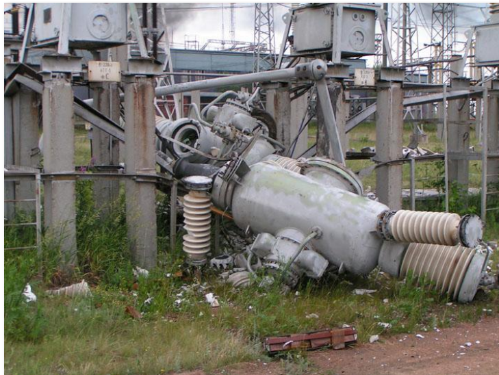
ПС 500 кВ Магнитогорская
