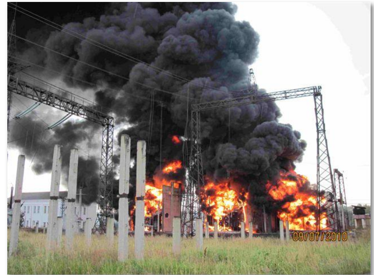
ПС 500 кВ Арзамасская
