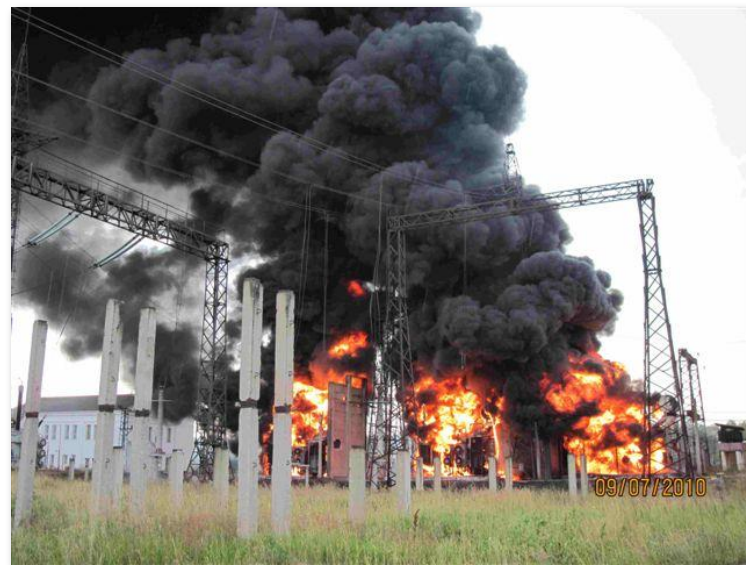
ПС 500 кВ Арзамасская
