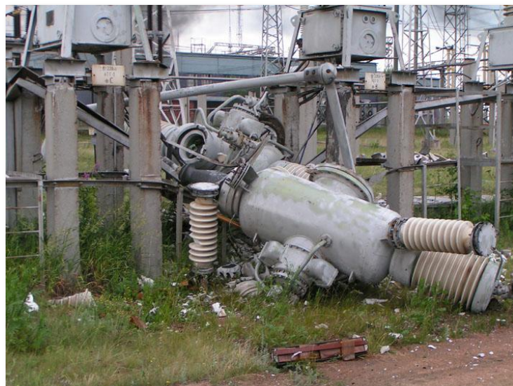
ПС 500 кВ Магнитогорская
