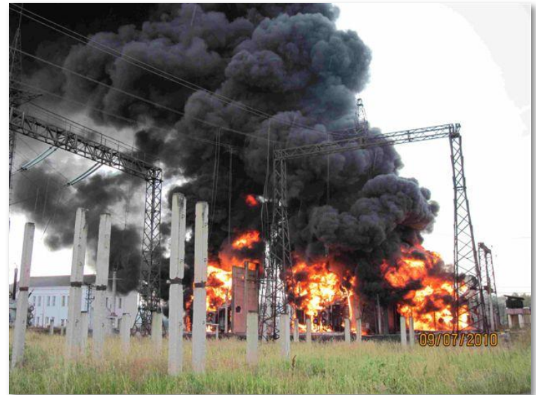
ПС 500 кВ Арзамасская
