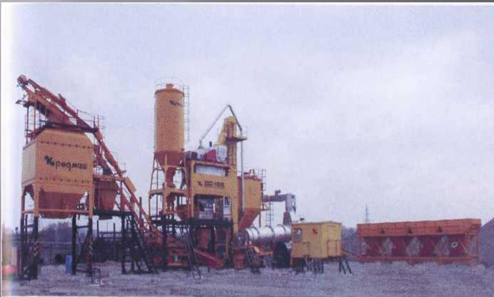
Асфальтосмесительная установка ДС-185
