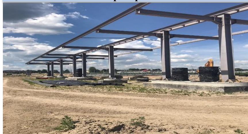
Навес с топливозаправочными колонками пункта заправки техники
