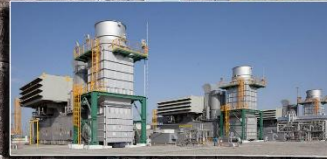
MARY 147 MWI LM 6000 ELEKTRİK STANSIÝASY
