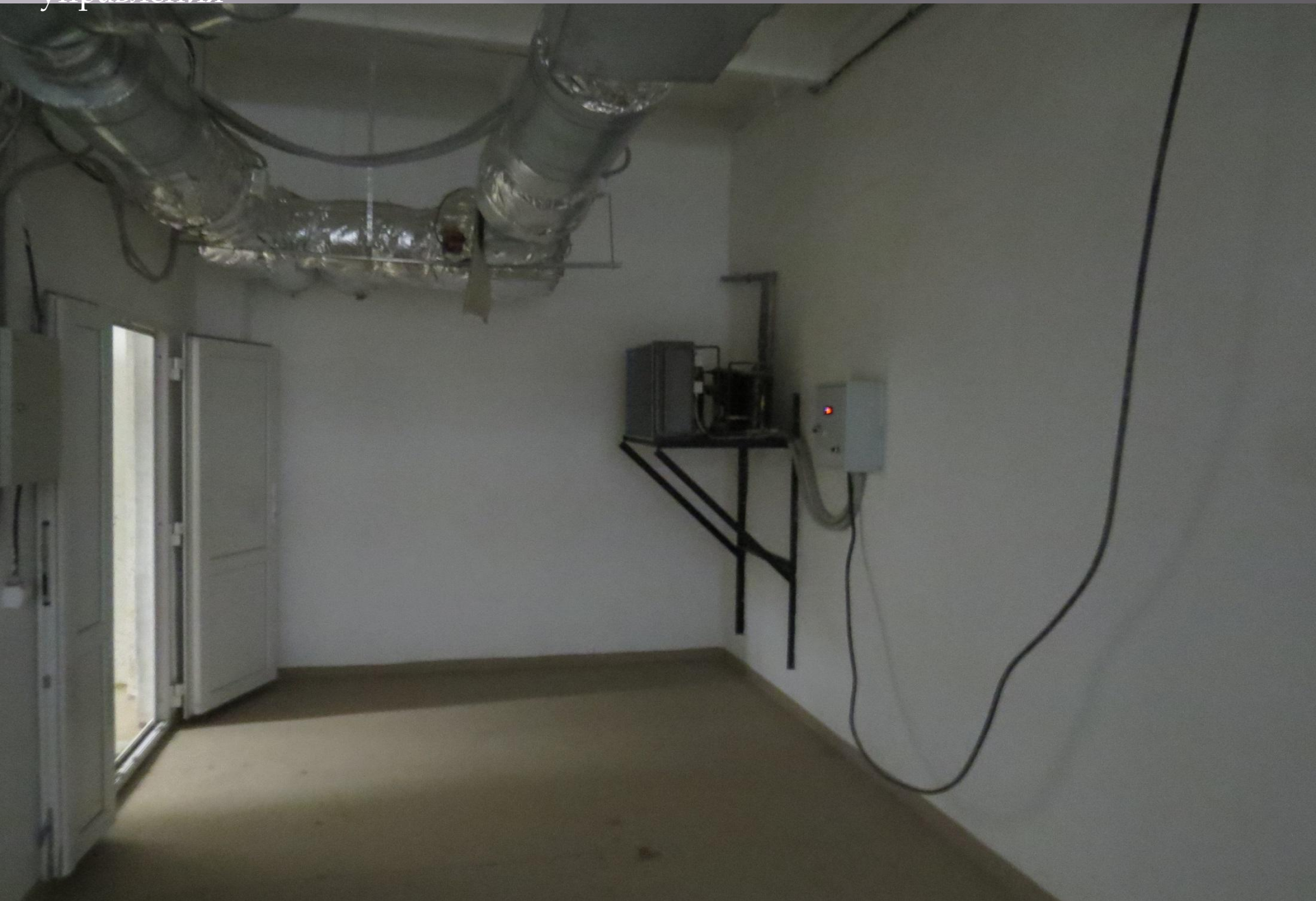
Общий коридор с установкой холодильника готовой продукции и пультом управления
