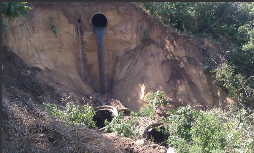
Разрушение трубопровода канализации
