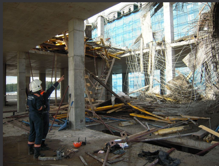
Обрушение здания на Урале
