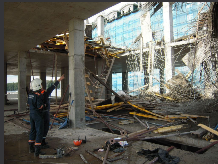
Обрушение здания на Урале
