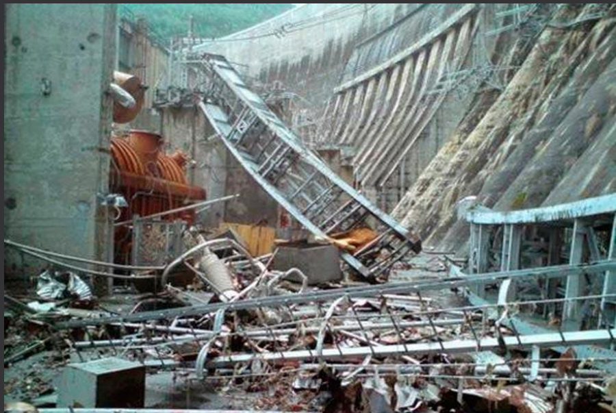
Авария на Саяно-Шушинской ГЭС
