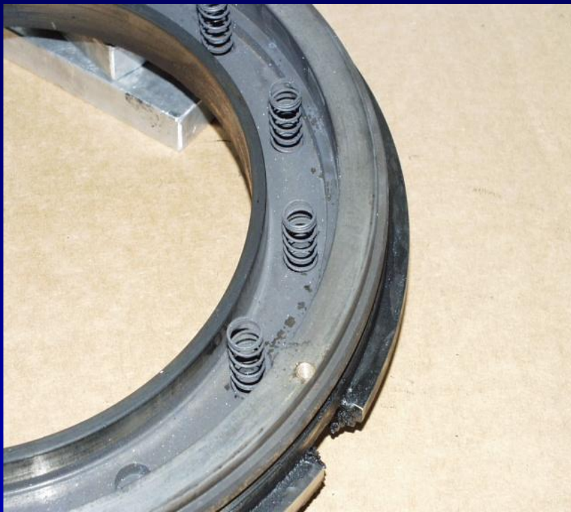
Загрязнение поверхностей со стороны процесса частицами
