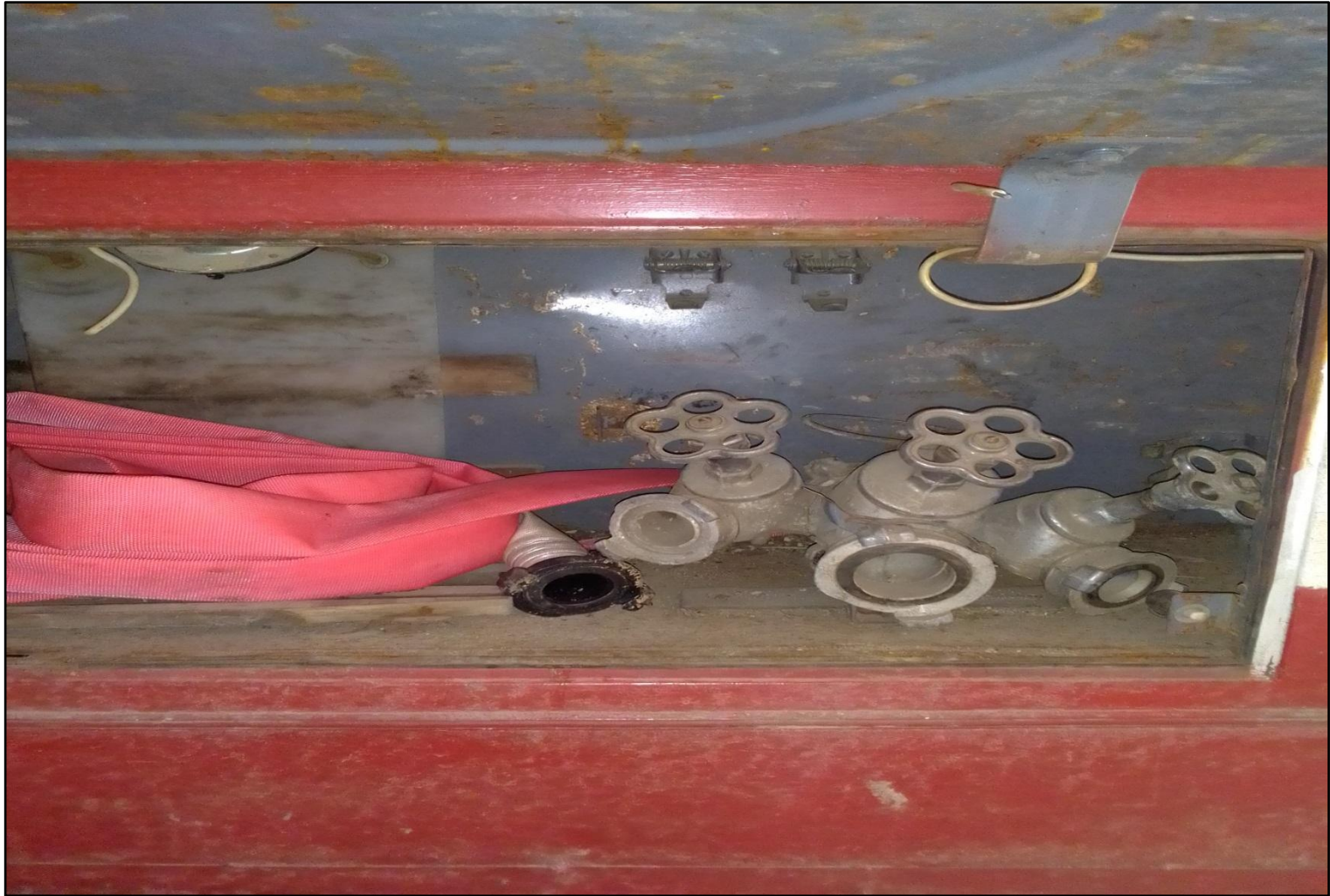
Рис. 6 Место для хранения пожарно-технического оборудования
