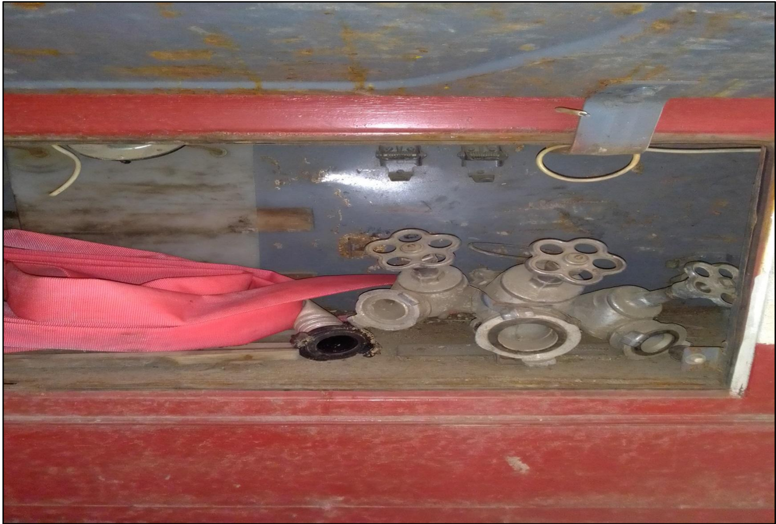
Рис. 6 Место для хранения пожарно-технического оборудования
