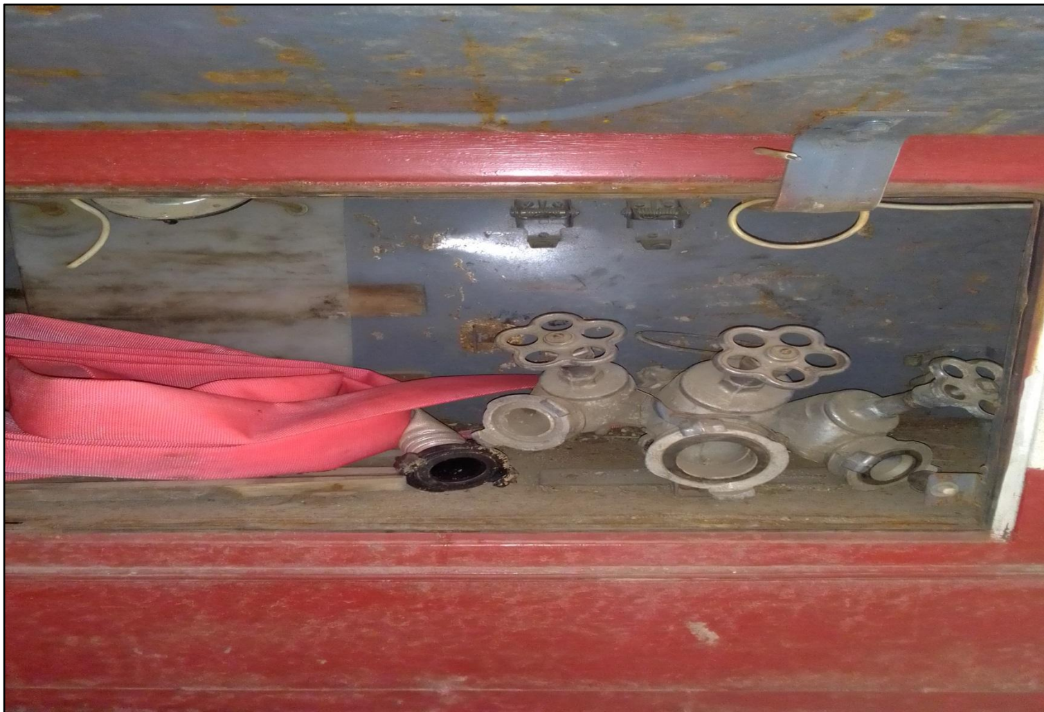
Рис. 6 Место для хранения пожарно-технического оборудования
