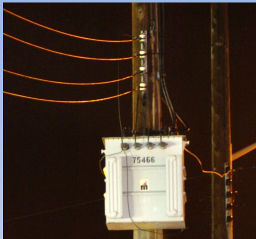
Трансформатор на линии электропередач
