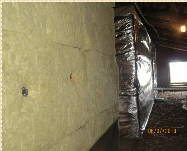
Теплоизоляция вентиляционной шахты
