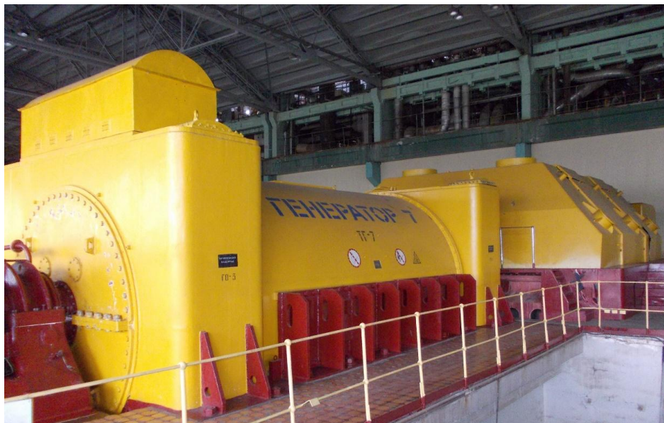
Турбогенератор мощностью 320 МВт
