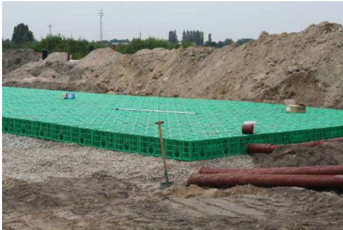
Отвод стоков биологического очистителя - 428 блоков
