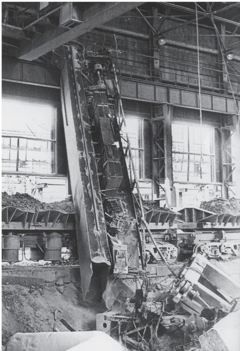
Рис. 5. Место аварии мостового магнитно-грейферного крана грузоподъемностью 15 т
