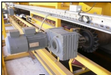
Привод конвейера с инвертором
