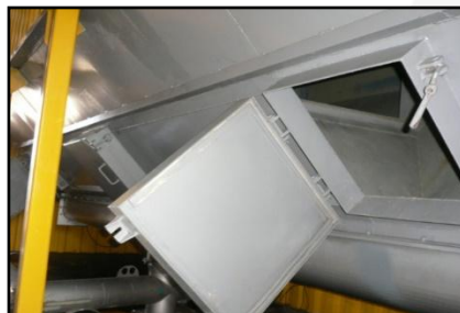
Люк силоса собственного заполнителя
