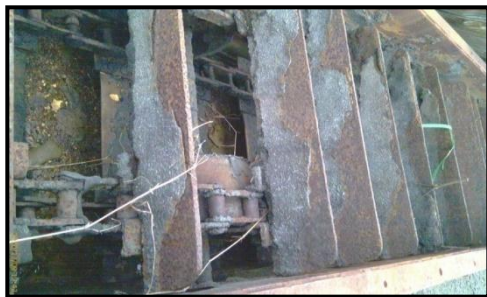
Изношенные цепи горячего элеватора
