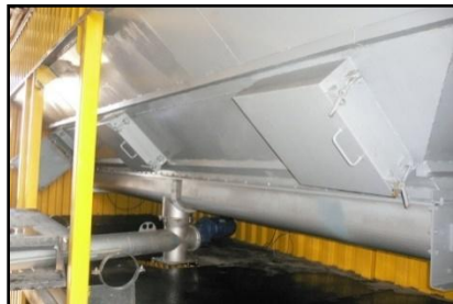
Силос собственного заполнителя
